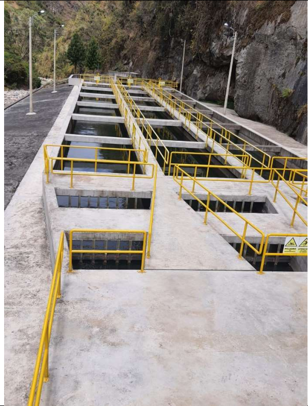
Cámara desarenadora Runatullo II, 3 cámaras
